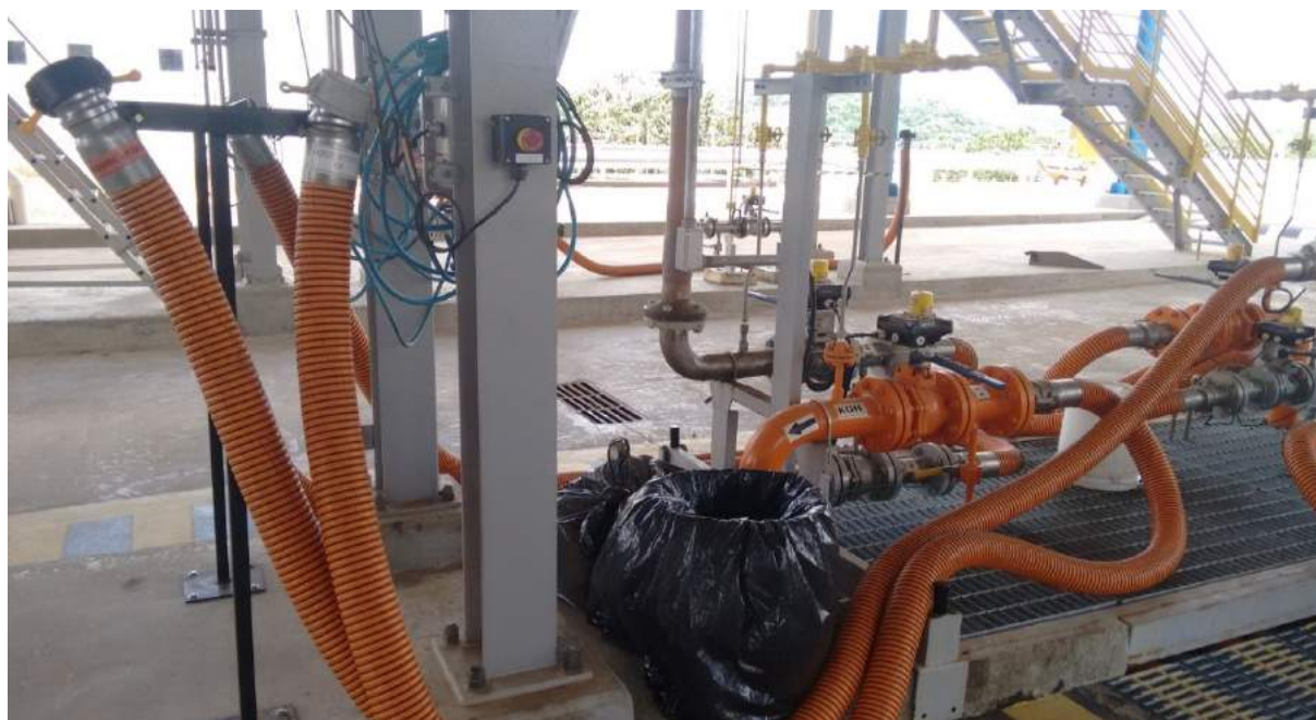
Figura 5.2.5 Sistema de sucção para descarregamento
