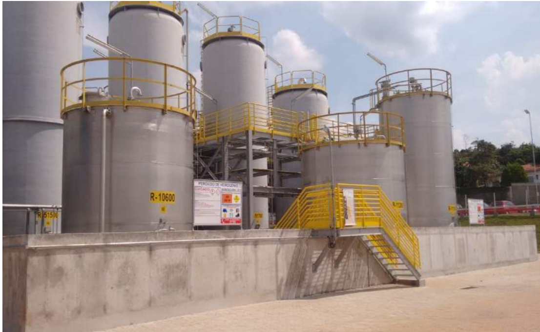
Figura 5.2.6- Tanques abastecidos por sistema de sucção
