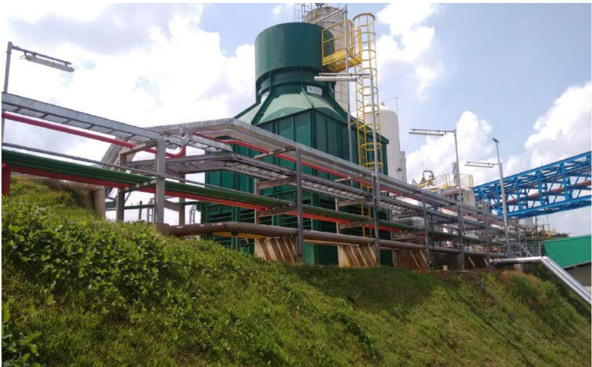
Figura 5.4 Sistema de reaproveitamento de água
