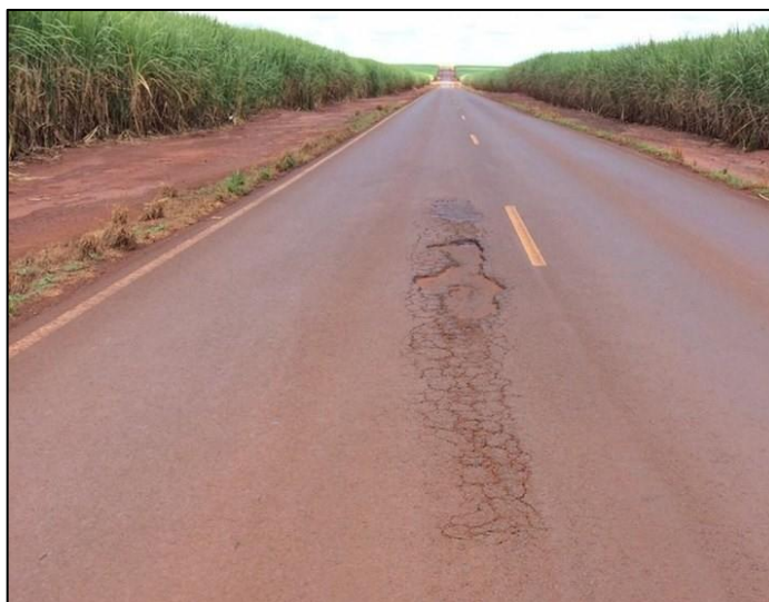
Figura 2 – Buracos na pista Fonte: próprio autor (2017)
